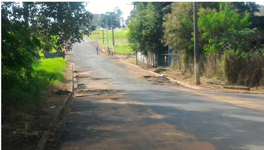
Foto 6.17 – Erosão na Estrada Municipal Alambrado
