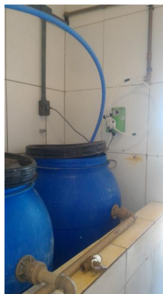
Foto 6.4 – Tanque de Flúor
