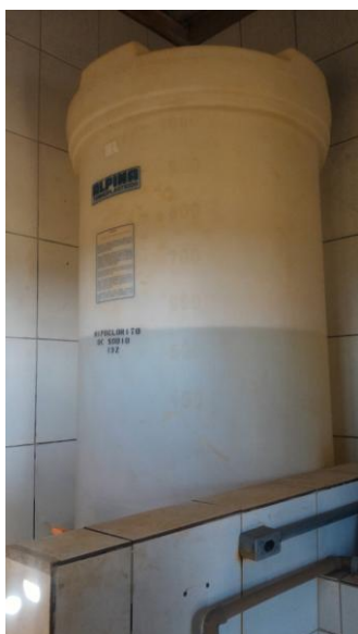
Foto 6.3 – Tanque de Hipoclorito de Sódio
