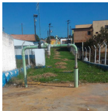
Foto 6.2 – Poço Profundo (P2)
