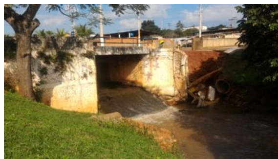
Foto 6.12 – Ponte com erosão – Rua Valdemar Zanata
