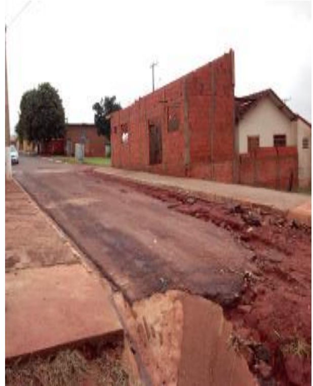
Data: 09/08/2018 Obs.: Rua Afonso Nascimento, próximo à Rodovia SP-225.
