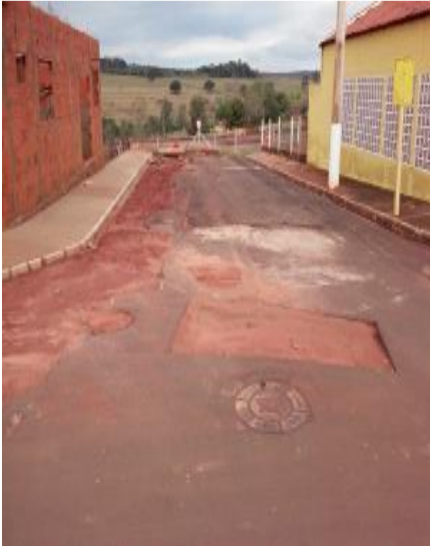
Data: 09/08/2018 Obs.: Rua Afonso Nascimento, próximo à Rodovia SP-225.
